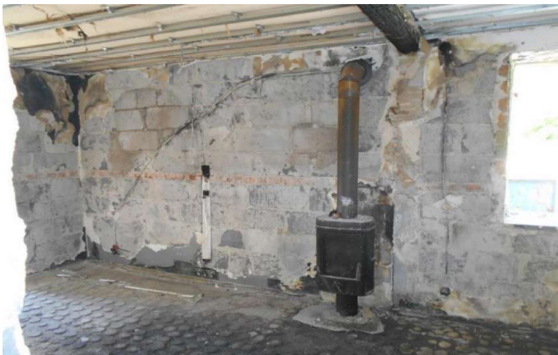
Zdjęcie 29. Widok na wnętrze salonu, gdzie doszło do zainicjowania pożaru.
