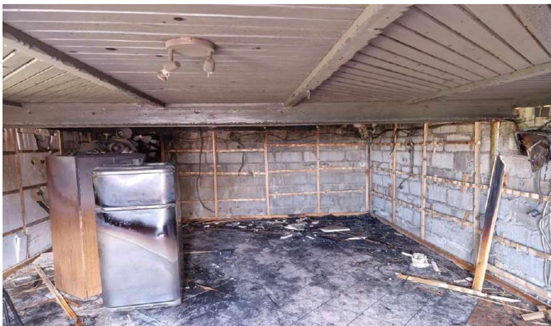
Zdjęcie 28. Widok wnętrza pomieszczenia po zakończeniu działań ratowniczo-gaśniczych, w którym miały zostać przeprowadzone oględziny pod kątem ustalenia przyczyn i okoliczności pożaru. Pomieszczenie po przeprowadzeniu zarówno prac rozbiórkowych dla okładziny ściennej, ewakuacji wszelkich przedmiotów z wnętrza, jak również po czynnościach porządkowych na podłodze pomieszczenia - podłoga została pozamiatana.
